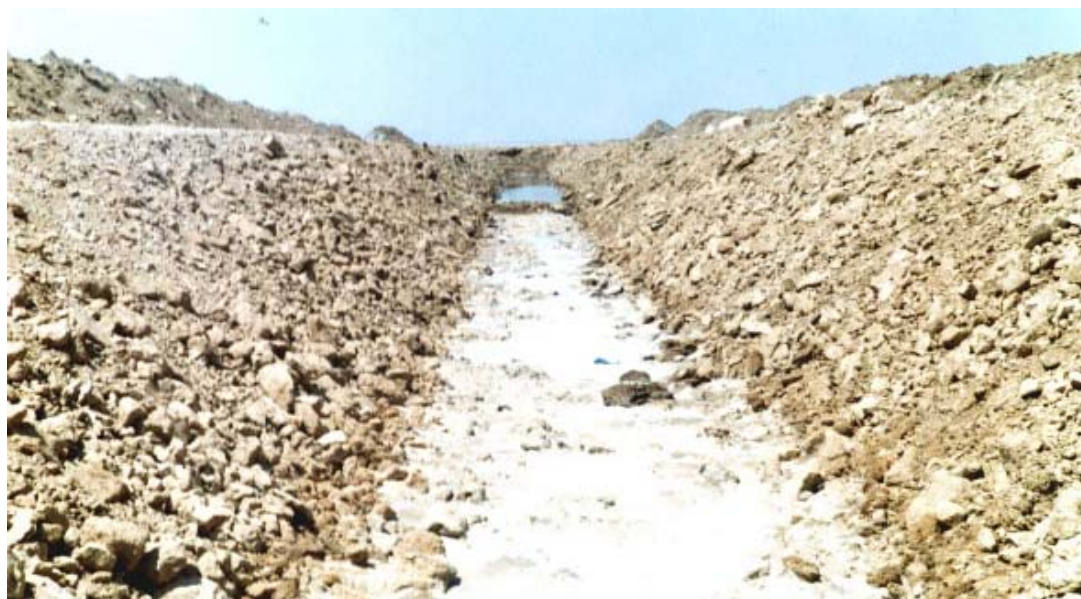
تصویر شماره (۱۳) - تماس کانال با آب زیرزمینی دارای یون کلرید و سولفات - رودست جنوبی
