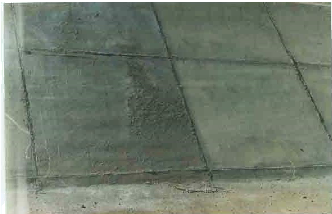
تصویر شماره (۵) - خوردگی پوشش بتنی کانال در اثر تماس با آب زیرزمینی
