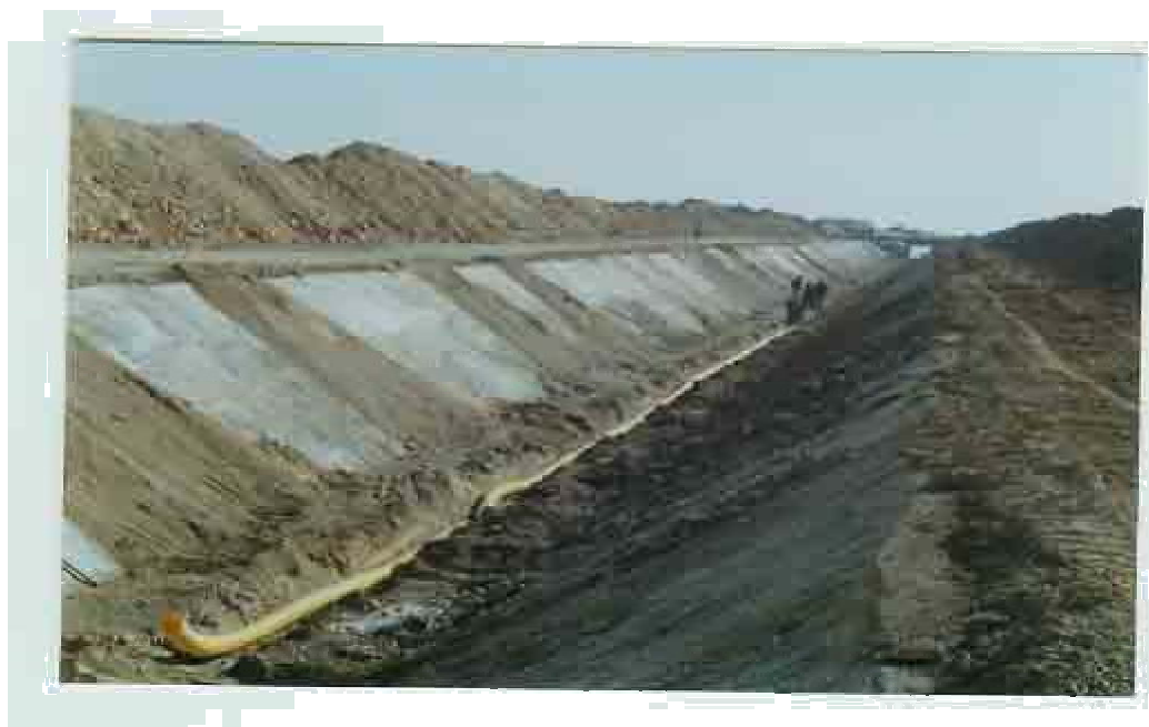
تصویر شماره (۲۵) - اجرای زهکش مدفون در کف کانال _ بتن مشهود مربوط به زیر سازی بوتیل است.
