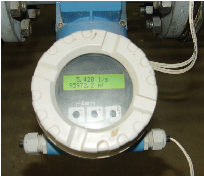
Fig. 5. Flow meter (Débitmètre)
