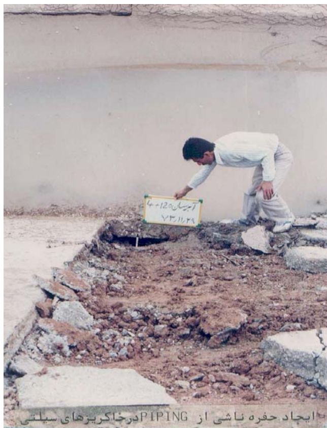
شکل شماره ۸- حفره ناشی از Piping
