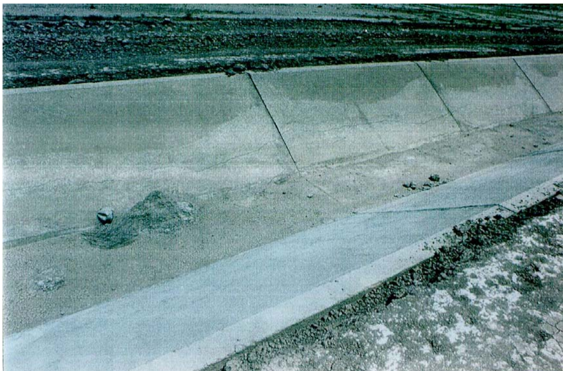
شکل شماره ۱ - ترک‌های مویی ناشی از انقباض بتن
