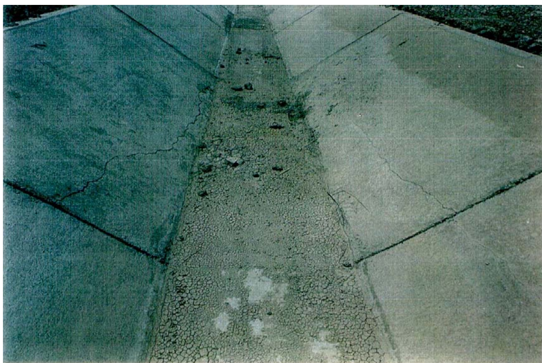
شکل شماره ۲ - ترک‌های مویی ناشی از انقباض بتن
