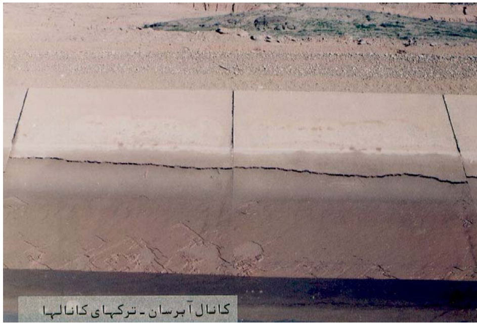
شکل شماره ۳ - ترکهای موازی بدون جابجایی دال
