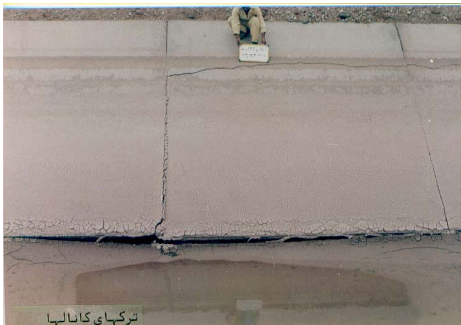
شکل شماره ۵ - ترکهای بیش از ۲ سانتی متر با جابجایی و پله شدن دال
