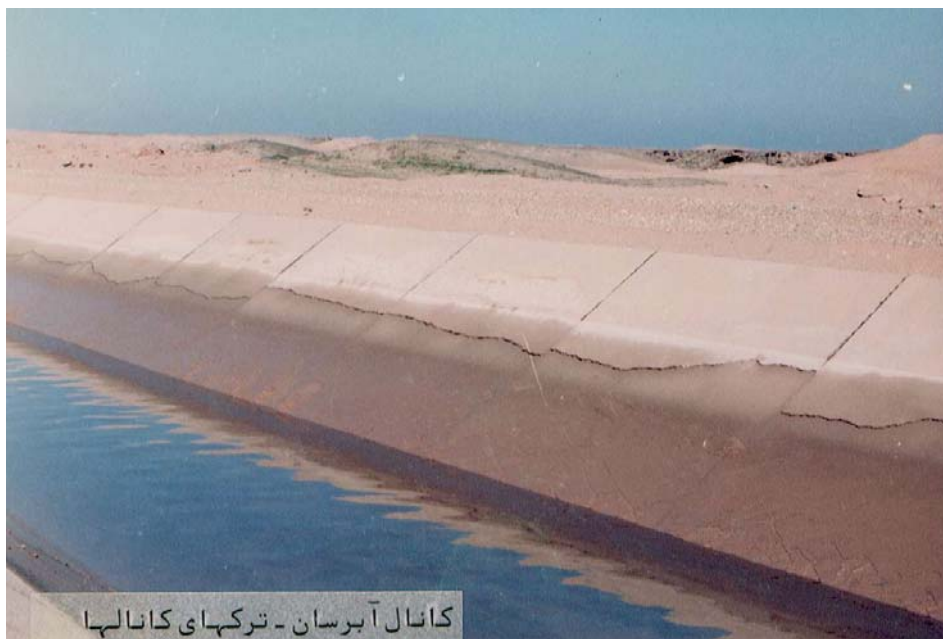
شکل شماره ۴ - ترکهای موازی بدون جابجایی دال
