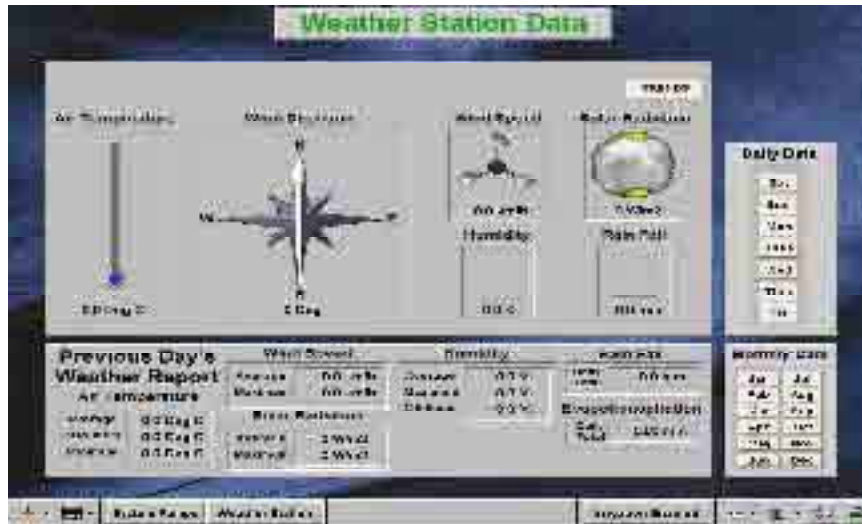
شکل ۳: اطلاعات ایستگاه هواشناسی در اتاق کنترل مرکزی
