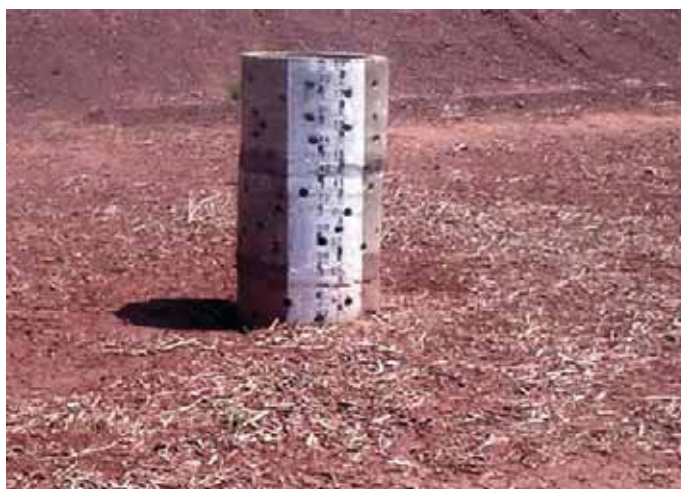
شکل شماره ۴ - نمونه ای از لوله‌های بتونی مشبک در داخل کانال
