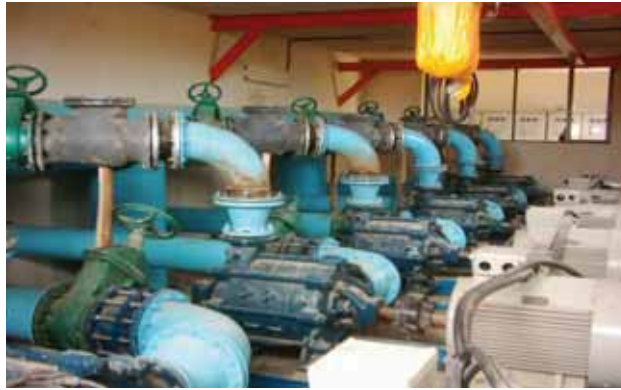
شکل (۷) - ایستگاه پمپاژ ثانویه
