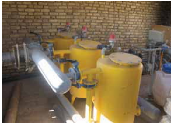
عکس (۲) - استفاده از فیلتراسیون مناسب در آبیاری قطره ای
