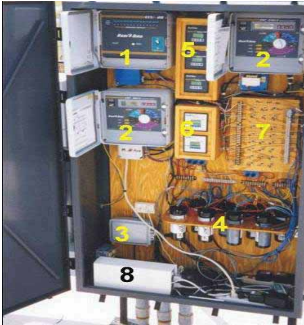
شکل (۴) - تابلو کنترل
