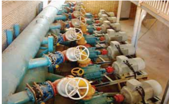
شکل (۵) - ایستگاه پمپاژ اولیه
